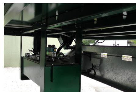
Aggregatbefestigung unter dem Container
