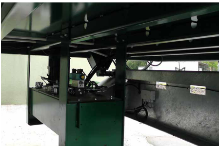
Aggregatbefestigung unter dem Container
